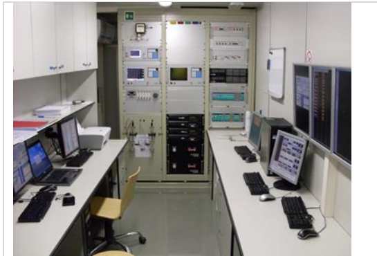
Fotografía 2-14 Unidad de Mud Logging
