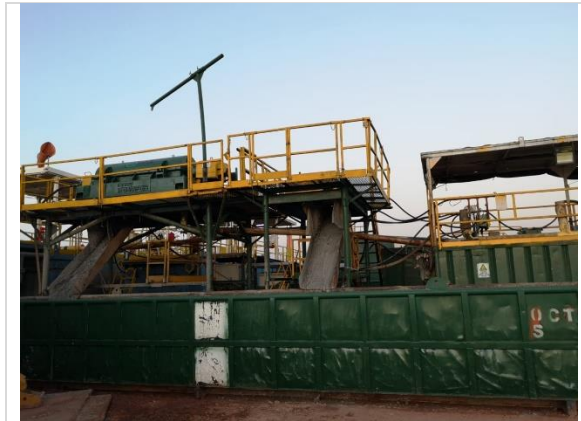
Fotografía 2-15 Equipos del sistema de control de sólidos
